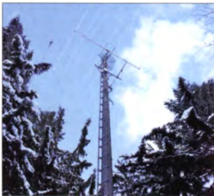
36 m hoher Schleuderbetonmast mit einem Mosley-Beam Pro-67-C3 bei einer IRB-Station in der Schweiz
