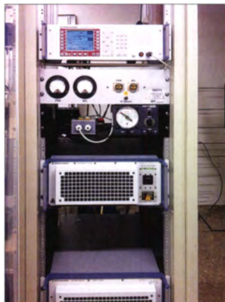
Hardware einer IRB-Station in der Schweiz: R&S XK2900 im Rack; außerhalb des Shacks werkelt ein R&S FK859-Antennenkoppler.
